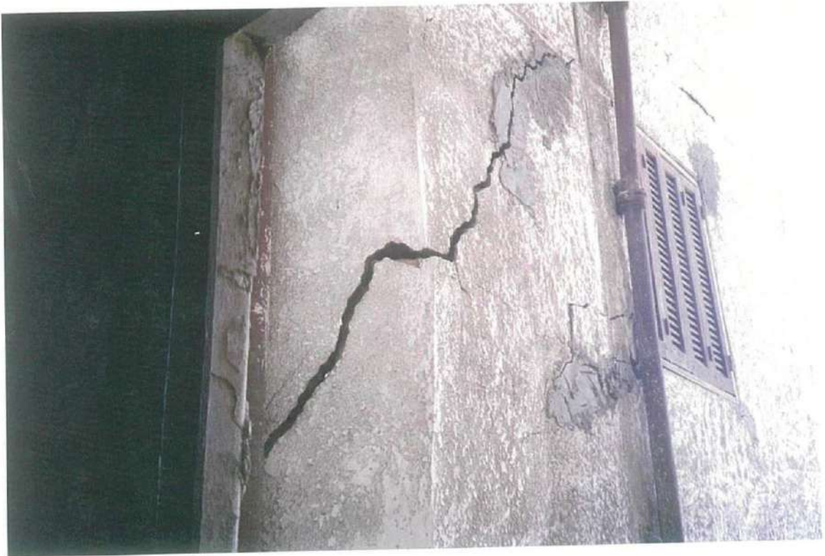
صورة رقم (٢٣-٣) توضح شرخ مائل نتيجة لفرق الهبوط
