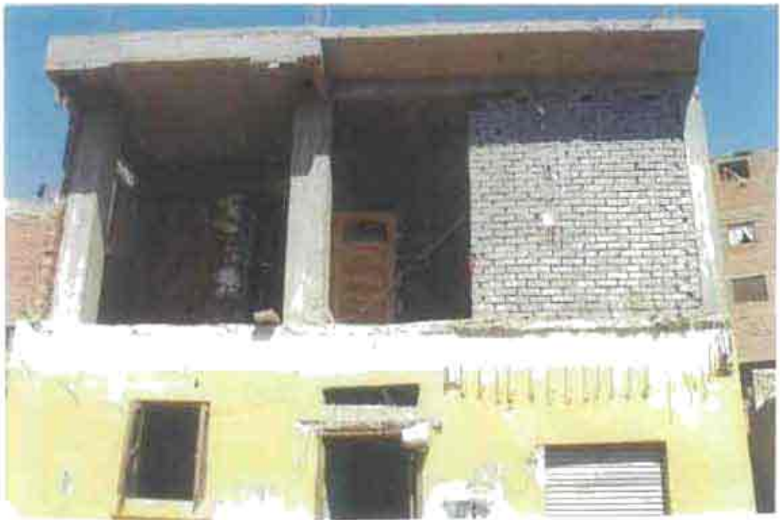
أشكال (٢-٣) (٢-٤) انهيار الكابولي الخرساني نتيجة عدم وضع حديد التسليح الرئيسي في مكانه ، حيث يظهر حديد التسليح في أسفل قطاع البلاطة الكابولية
