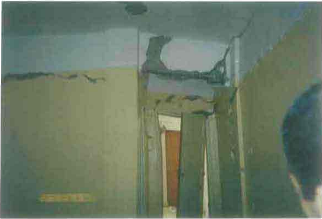
صورة رقم (٢٥-٣) توضح ميول واضحة بالسقف بها شروخ بالكمرات بسبب فرق الهبوط
