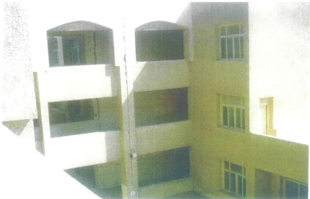
صورة رقم (٣-٣٢) توضح إتساع فواصل التمدد الرأسية والافقية بين أجزاء المبنى
