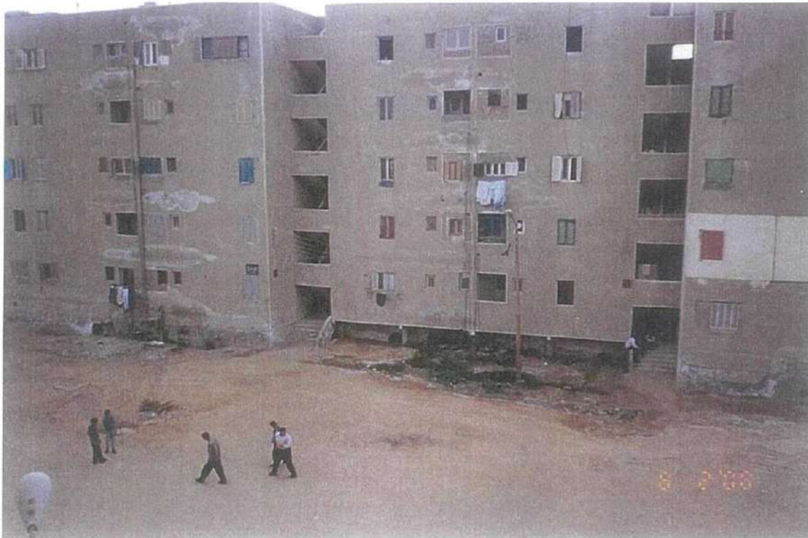
صورة رقم (٥٨-٣) توضح تراكم مياه الصرف الصحي الخاصة بالعمارتين على الأرض نظراً لسوء السباكة للعمارتين
