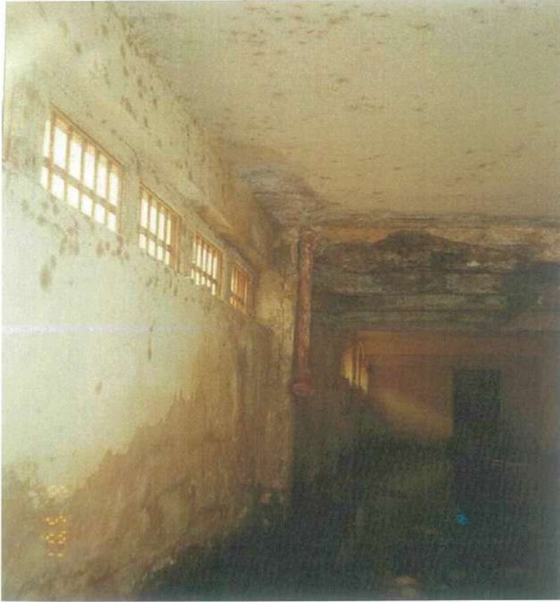
صورة رقم (٥٣-٣) توضح تآكل حديد التسليح وخرسنة السقف بالجراج بالبدروم بسبب سوء حالة الصرف الصحي وتراكم المياه بالبدروم
