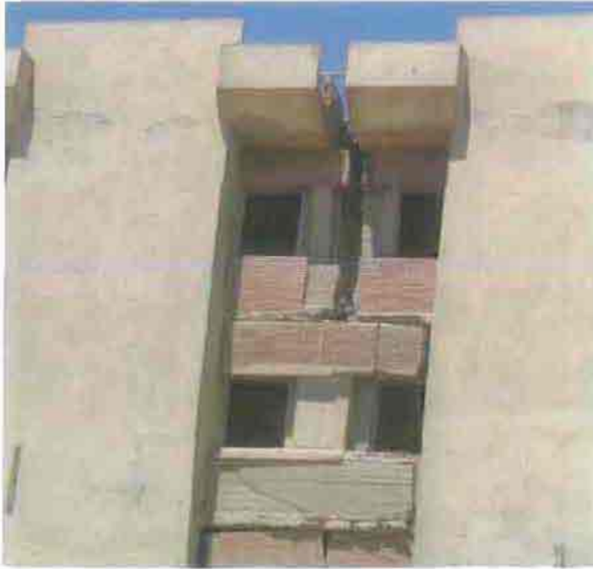
صورة رقم ( ٣-١٦ ) : توضح الضرر لحادث بأحد المباني الحكومية بسبب القرية |٤١|
