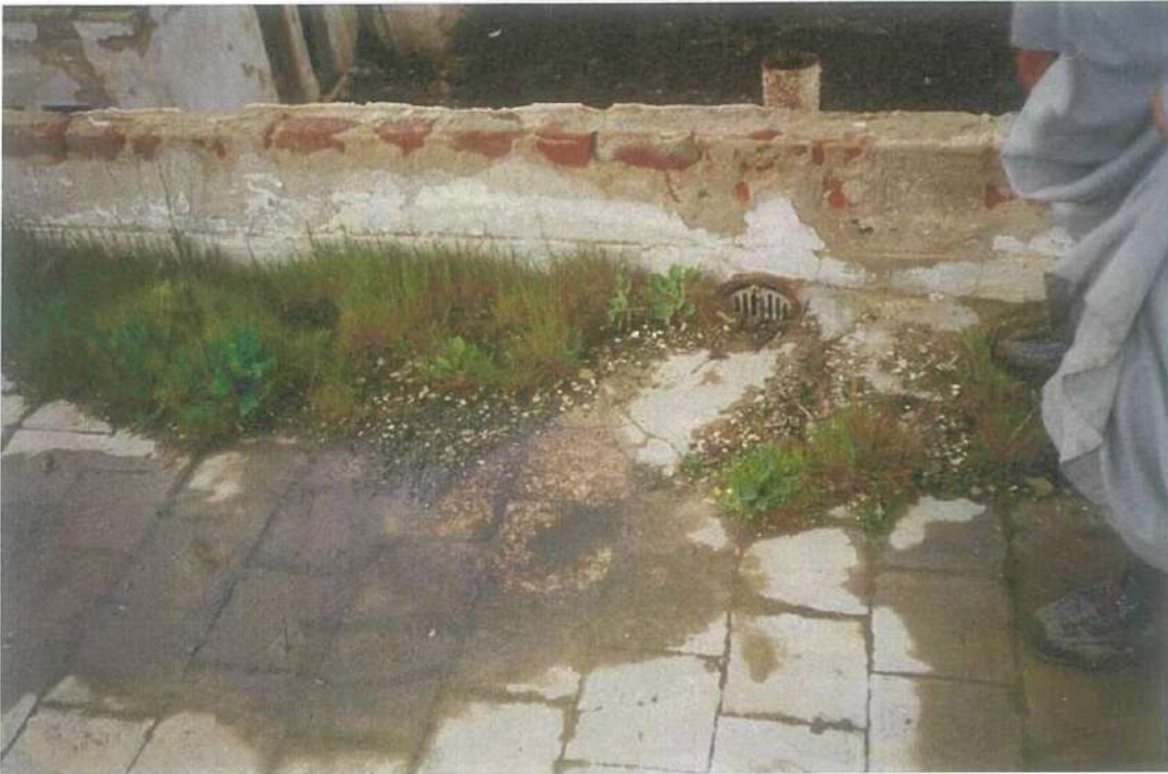
أشكال (٢-٢٥) (٢-١٦) تراكم المياه ونمو النباتات على السطح النهائي للمبنى وذلك لعدم وجود ميول سنيمة لأصرف المياه وانسداد البالوعات الخاصة بصرف المياه.
