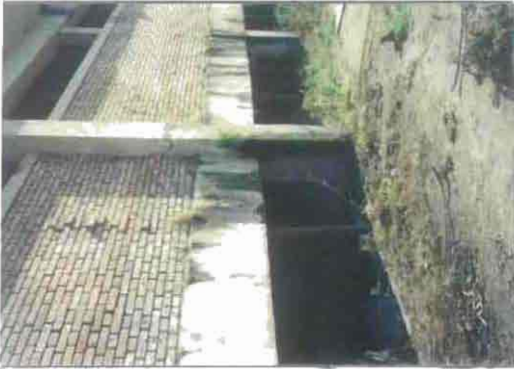
شكل (١٨-٢) نمو النباتات والاعراض على المصنوع مما تسبب في حدوث تصدعات بها ، وكذلك فإن عدم الصيانة اللازمة للنباتات الملاصقة للمباني لها تأثير سيئ على سلامة المبنى
