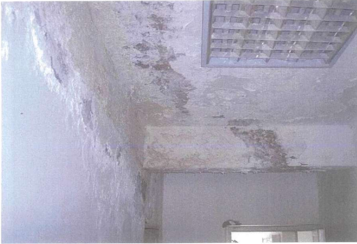
صورة رقم (٥٧-٣) توضح تآكل شديد بتسليح السقف الخارجي بالمدخل الخلفي بسبب سوء حالة الصرف الداخلي والخارجي
