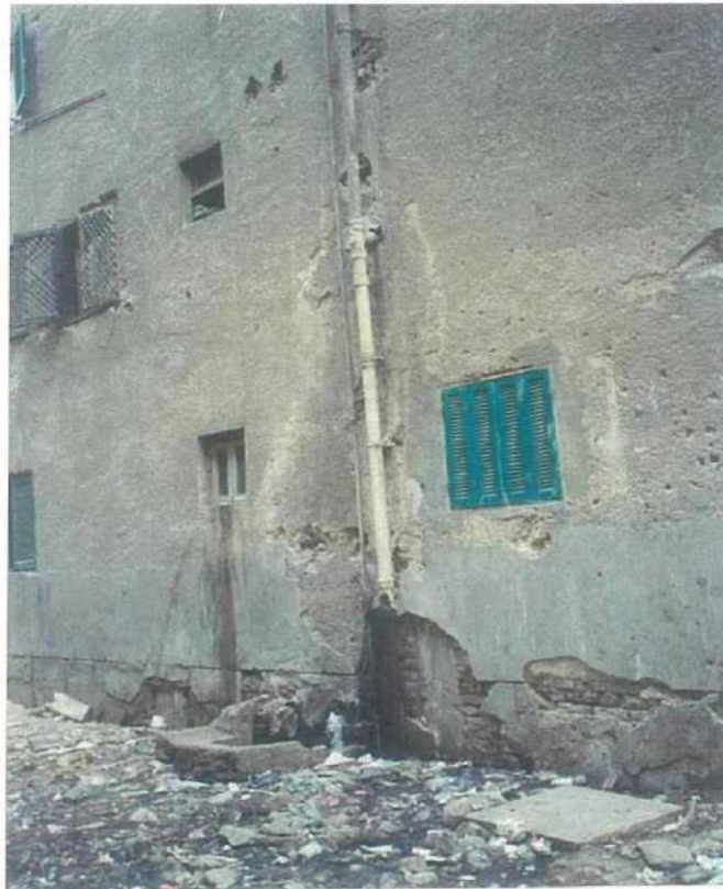
شكل (٢-٣٢) كسر في أحد مواسير الصرف الصحي بعمارة سكنية مما تسبب في تآكل البياض وتصدع العناصر الإنشائية .
