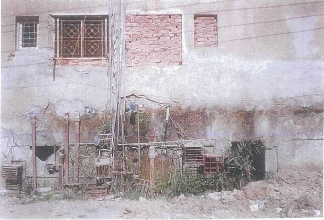
صورة رقم (٦٣-٣) توضح تهالك طبقات البياض وظهور التلميح على الخرسانة المسلحة لأساسات العمارات بسبب سوء وصلات الصرف
