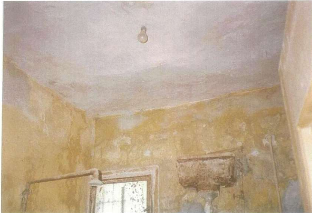
شكل (٢-٣٦) تسرب المياه بالسقف الخرساني لدورة المياه تسبب في حدوث صدأ بحديد تسليح البلاطة الخرسانية مع حدوث ترخيم بها واضح بالعين المجردة ، وتسرب مياه بالحوائط
