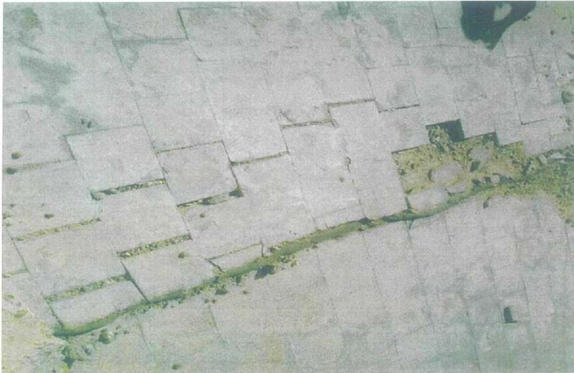
صورة رقم (٣-٣٨) توضح حركة بلاطات الأرضيات بالسطح عند مناطق فواصل أجزاء المبنى نتيجة لفرق الهبوط بين الأساسات
