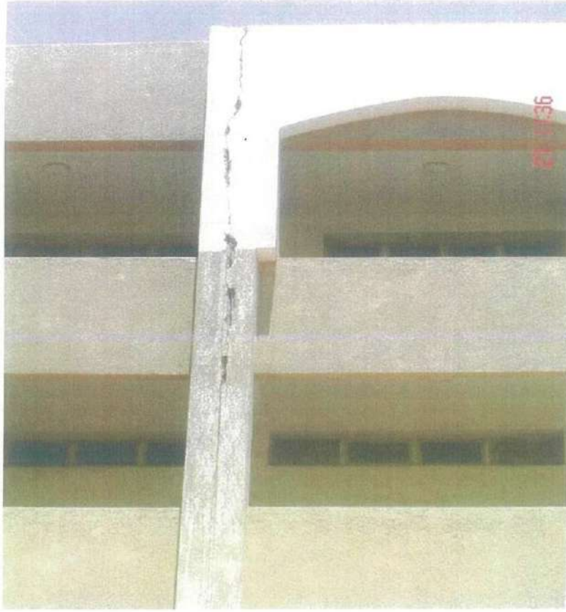
صورة رقم (٣٥-٣) توضح إتساع فواصل التمدد الرأسية والأفقية بين أجزاء المبنى
