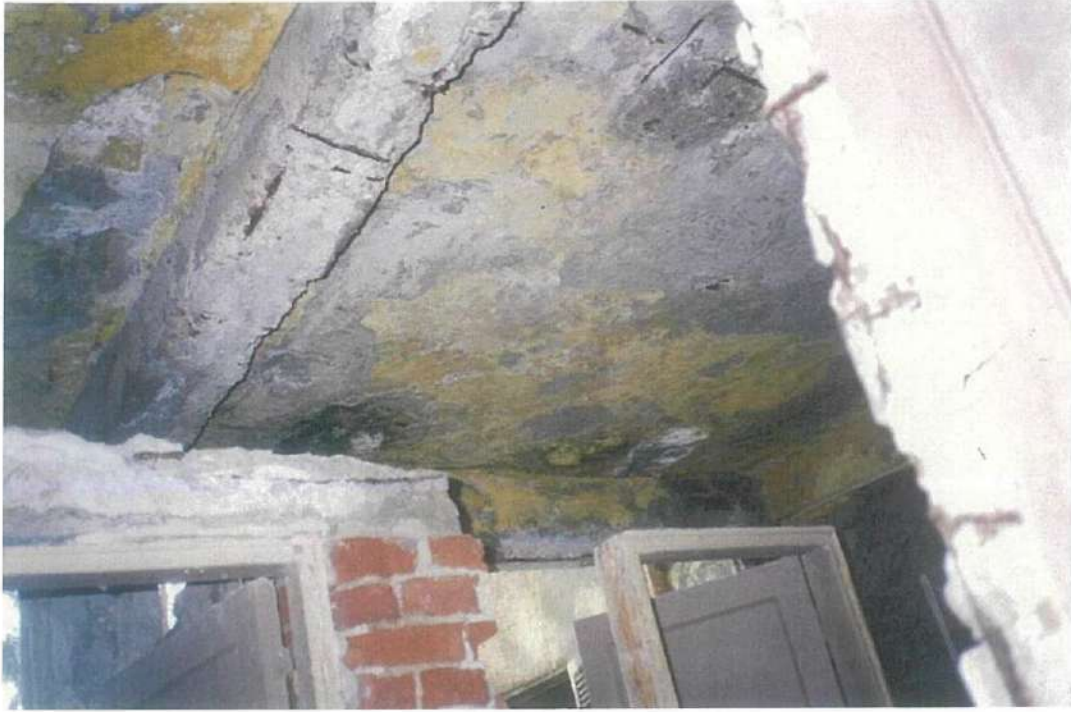
شكل (٢-٣٥) رطوبة شديدة ببلاطة اسقف والكمرات الخرسانية لدورات المياه لأحد المباني نتيجة عدم صيانة اعمال السباكة والصرف الصحي مما تسبب في تصدع السقف وتآكل الحوائط وكذلك أعمال النجاره.
