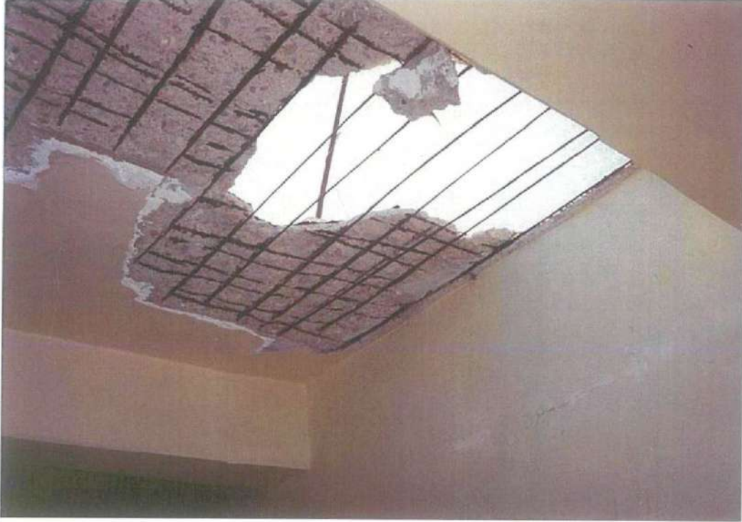
شكل (٢-٢٩) إنهيار كامل لسقف نهائى نتيجة صدأ وتآكل حديد التسليح لوجود نسبة عالية من أملاح الكلوريدات بالخرسانة وعدم صرف مياه الأمطار
