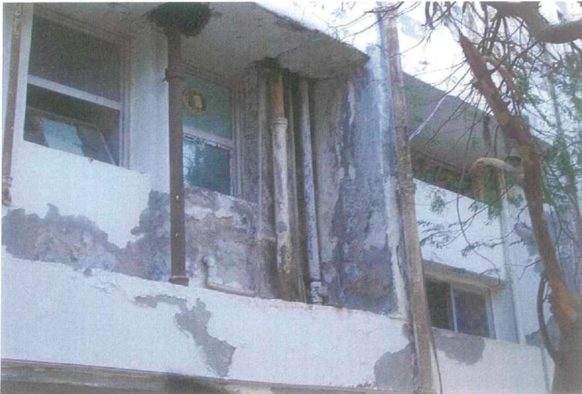
صورة رقم (٥٦-٣) توضح نشع شديد بسقف وكمرات واعمدة المدخل الخلفي بسبب سوء حالة الصرف الخارجي
