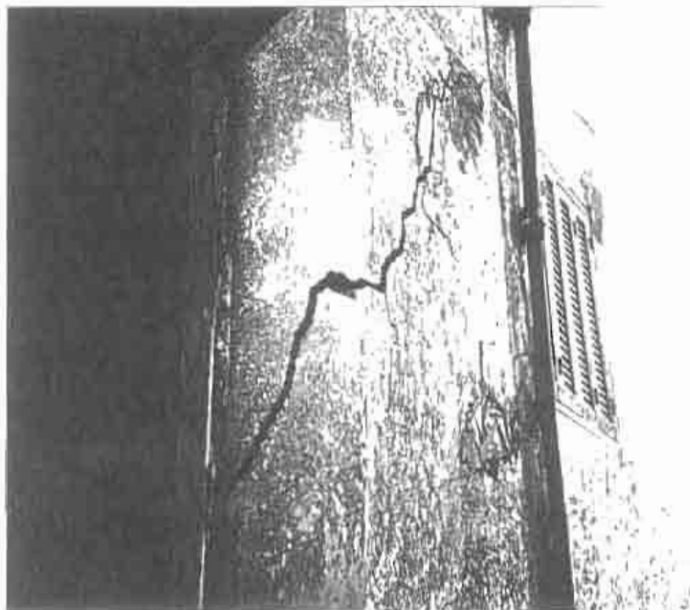
صورة رقم ( ٣-٣ ) : توضح شروخ نافذة بالحوائط في مبنى قائم بسبب إنشاء مبنى مجاور [١١]
