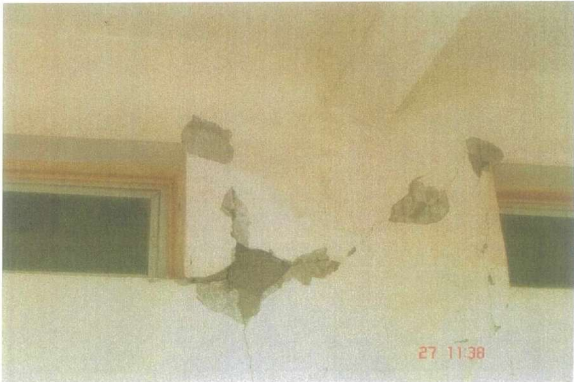
صورة رقم (٢١-٣) شروخ مائلة إلى أفقية نافذة في الحجرة نتيجة لفرق هبوط بين الاساسات
