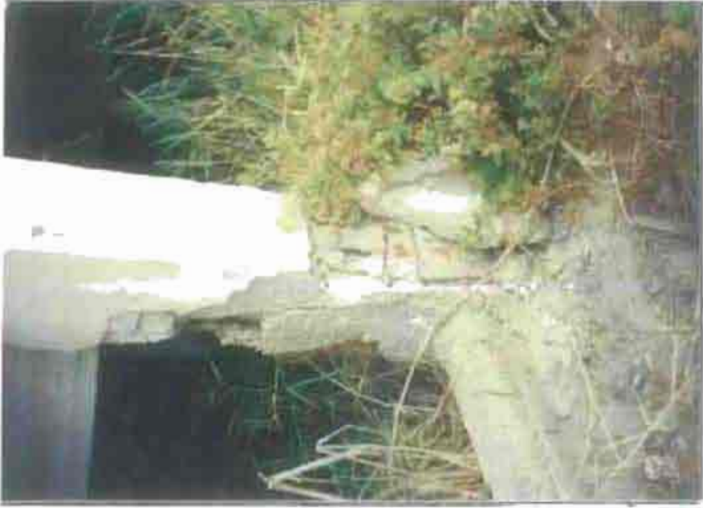
شكل (١٧-٢) سوء تنفيذ الخرسانة نتيجة عدم استبعاد المواد المستخدمة في تصنيعها والتأكد من استبعادها للمواد الضارة مما تسبب في صدأ الحديد والخراب للنباتات الملاصقة للخرسانة مما سبب في تصدع الخرسانة الإعدة نتيجة عدم الصيانة
