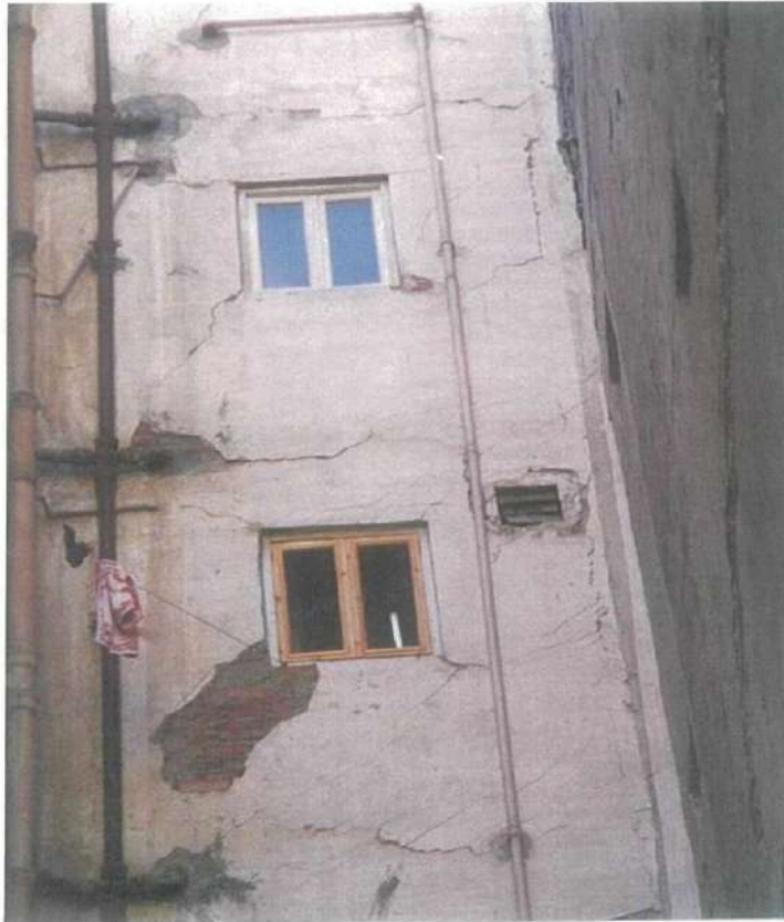
صورة رقم (٢٩-٣) توضح انشروخ في حوائط وأعمدة وكمرات المبنى كنتيجة لسوء حالة الصرف الصحي
