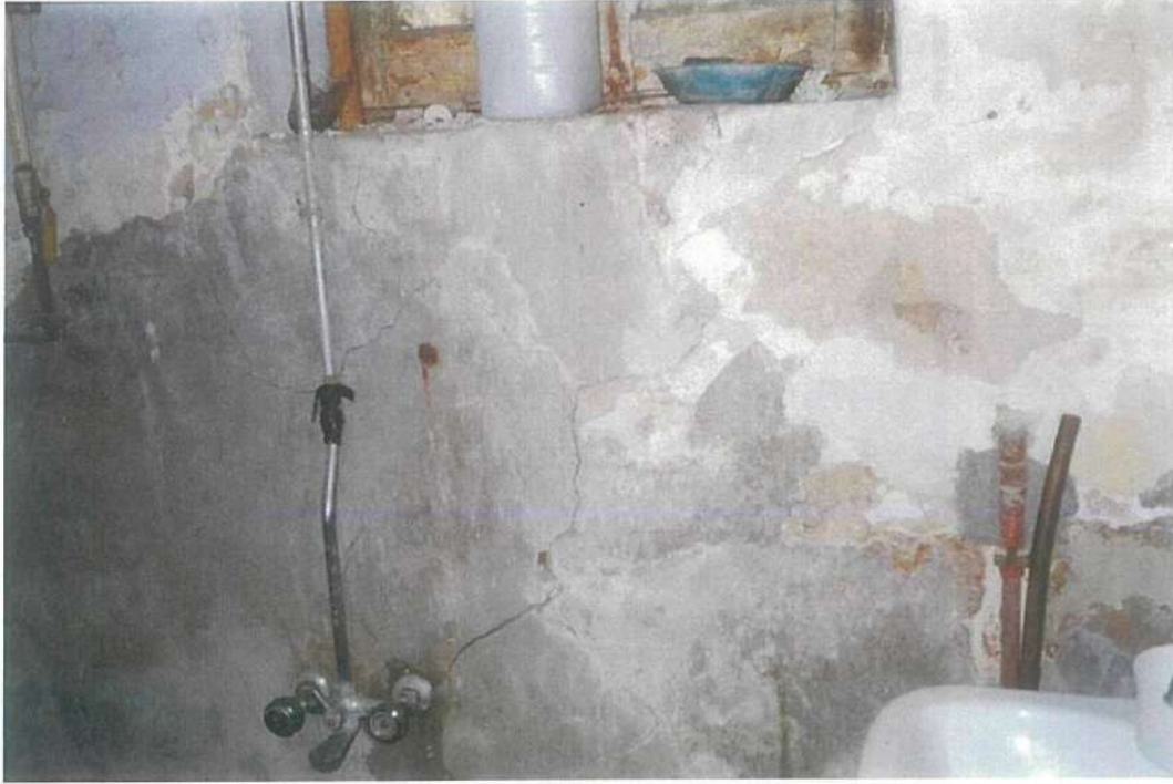
شكل (٣٧-٢) سوء حالة أعمال السباكة ودورات المياه .
