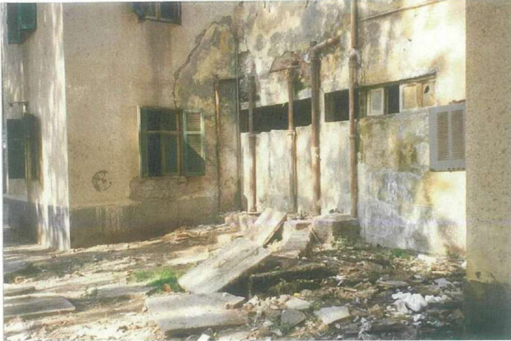
شكل (٢-٣١) تسرب المياه من مواسير الصرف الصحي وحوث نشع للمياه وتمليح ونمو الطحالب على الحوائط بأحد المستشفيات وتراكم القمامة حول حجرات التفتيش
