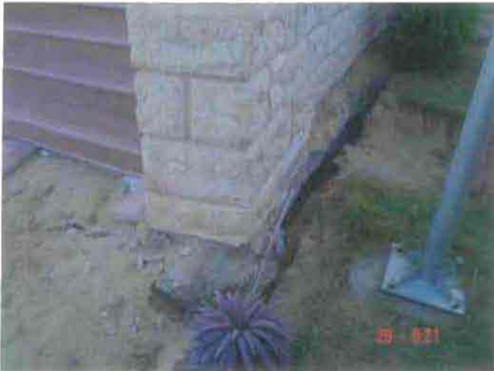
صورة رقم (٧٣-٣) لتهبوط التربة حول المبنى
