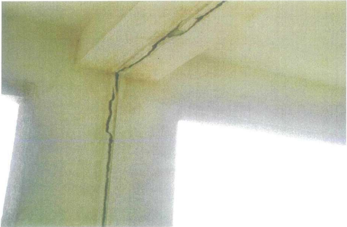
صورة رقم (٣-٣١) توضح سوء حالة فواصل التمدد الرأسية والافقية بين أجزاء المبنى
