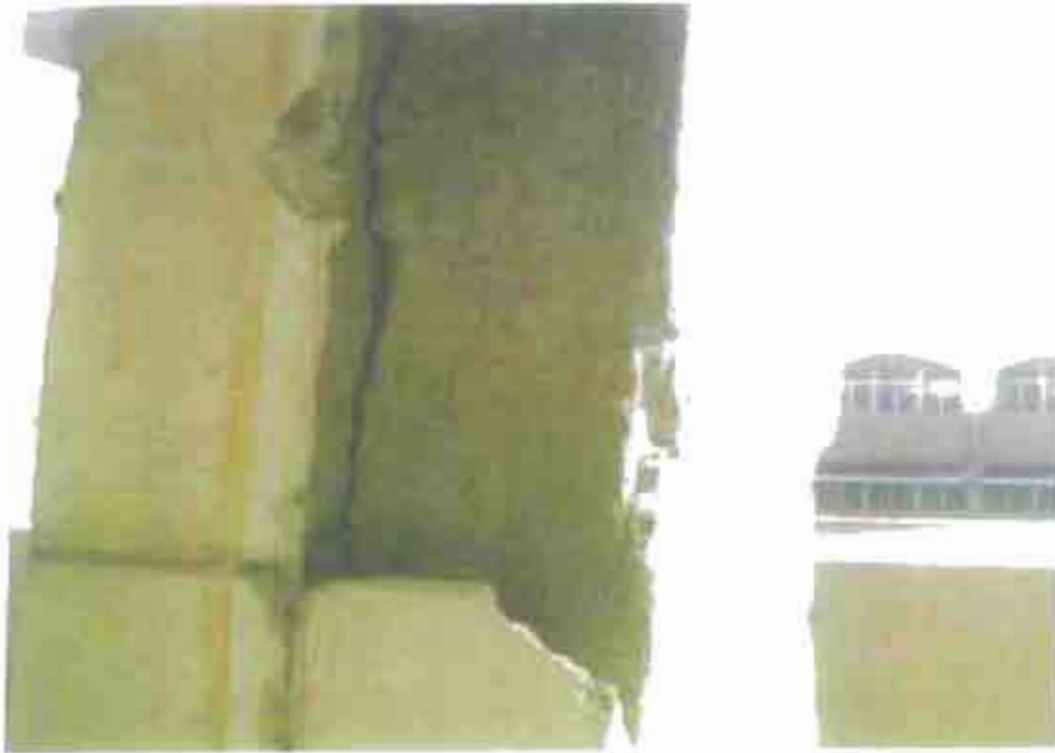
صورة رقم (٣-٣٣) توضح إتساع فواصل التمدد الراسية والأفقية بين أجزاء المبنى
