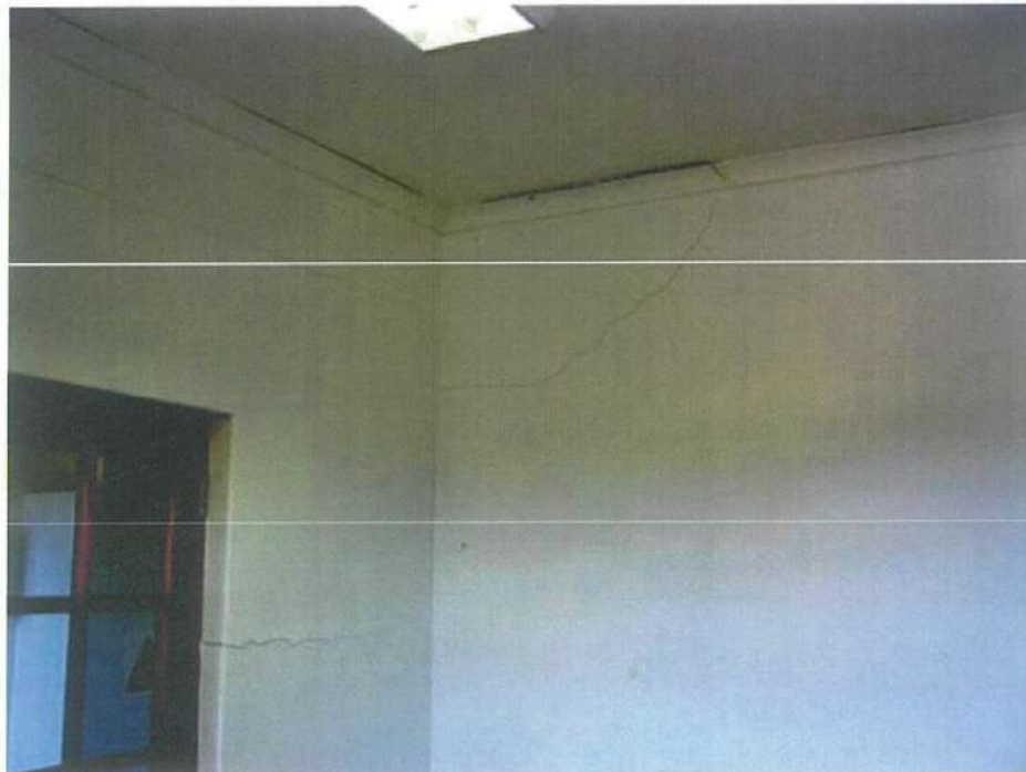
صورة رقم ( ١١-٣ ) : توضح شروخ متنوعة بالحوائط بالمجمع الرياضي بجنوب أفريقيا بسبب تربة انتفاخية [٣٨]
