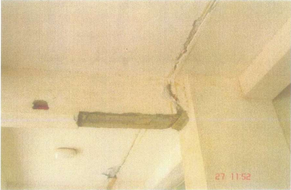
صورة رقم (٣-٣٧) توضح سوء حالة فواصل التمدد مع وجود إتساع ببعض فواصل التمدد بالمبنى
