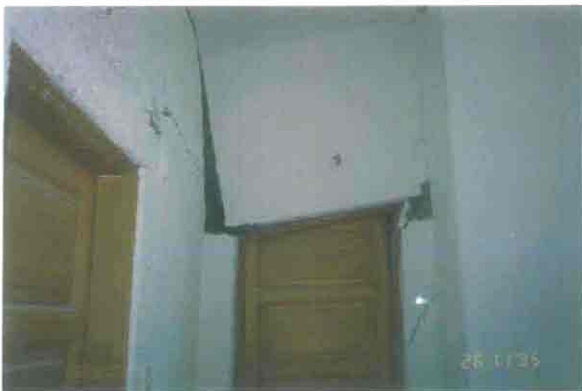
صورة رقم (٢٦-٣) توضح ميلول واصحة بالسقف وكسر بالكمرات بسبب فروق الهبوط
