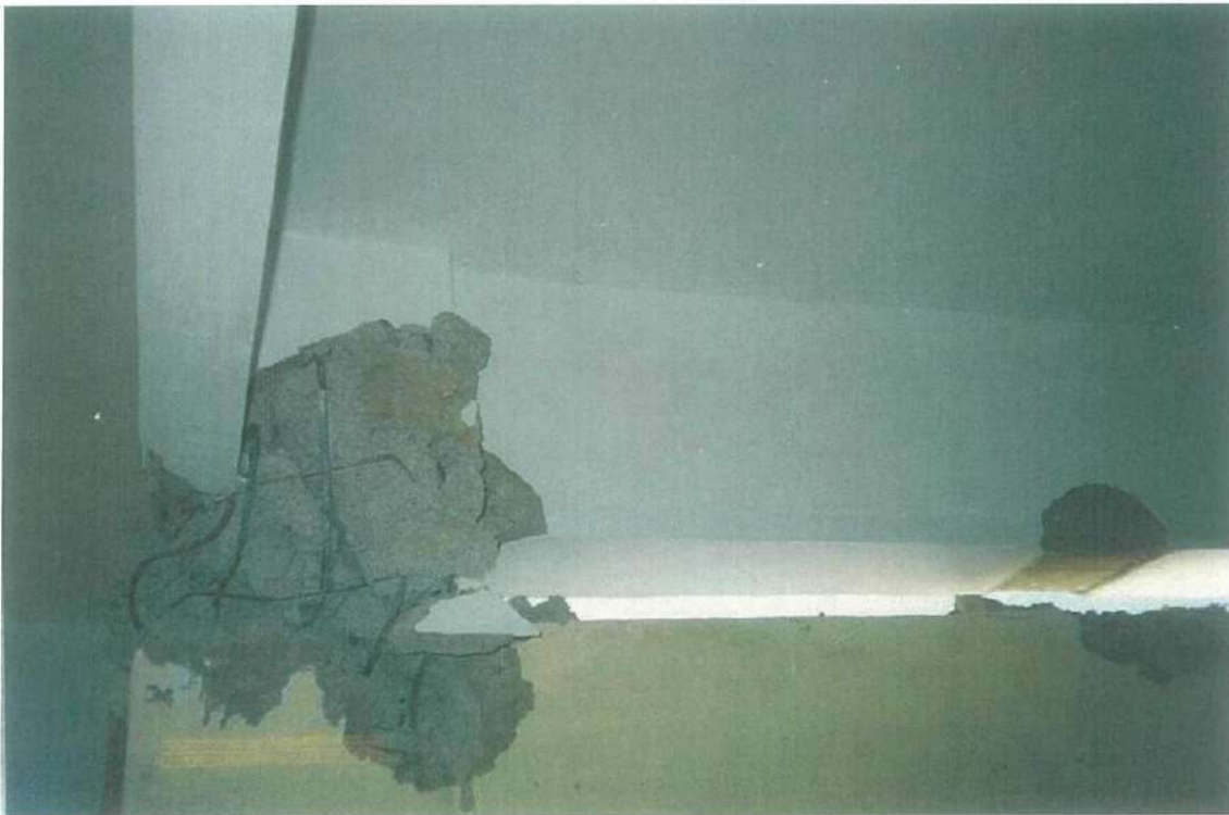
صورة رقم (٣-٤٠) توضح كسر بأحد الأعمدة وتلاشى العمود بمنطقة الشبابيك
