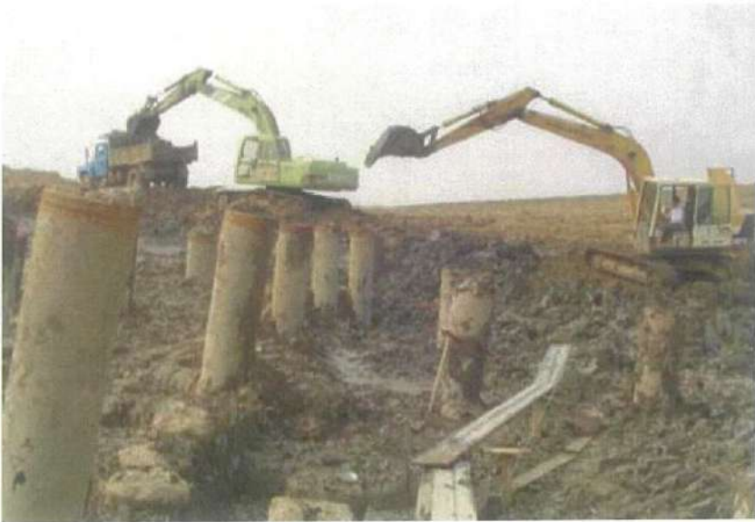
صورة رقم ( ٣-١٥ ) : توضيح انهيار خوازيق بسبب تسيل التربة بجنوب الصين [٥٦]
