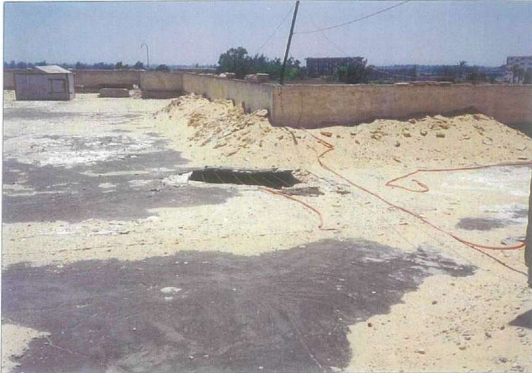
شكل (٢-٣٠) شكل الإنهيار من أعلى حيث لا يوجد أى نظام لصرف مياه الأمطار
