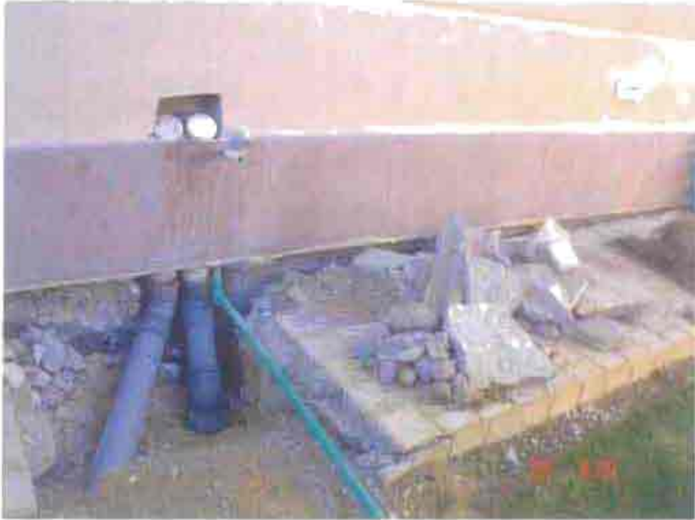
صورة رقم (٧٢-٣) لتهبوط الرصيف حول المبنى وكسر مواسير الصرف
