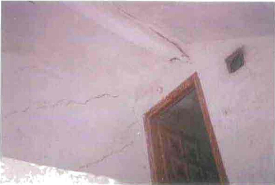
صورة رقم (٢٤-٣) توضح شروخ مائلة بسبب فرق الهبوط
