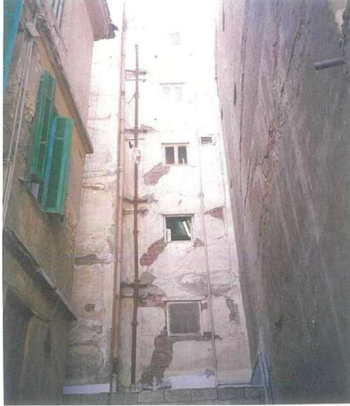
صورة رقم (٢٨-٣) توضح ان الشروخ المائلة ظهرت في مناطق الضعف التي سببها سوء حالة الصرف الصحي بالإضافة إلى فرق الهبوط
